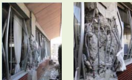
出典: 国土技術政策総合研究所、建築 研究所 平成23年4月4日 「白河市、須賀川市、仙台市におけるRC造、 S造、非構造部材を中心とした建築物被害調 査(速報)」
