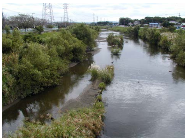
写真-11 河床の砂堆積（釜神付近）
