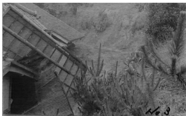
坂田地区・君津クラブ裏土砂崩れ 家屋損壊
